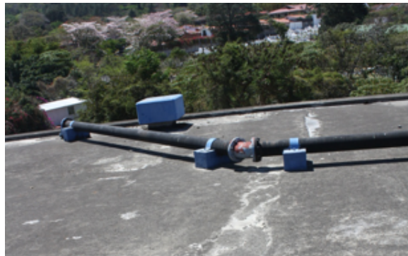
Figura 9 Imagen del techo del tanque Cementerio Escazú. Se puede ver resanes realizados en zonas muy bien definidas.
